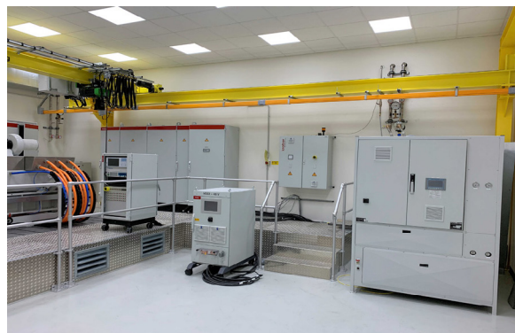
Thermische Konditionierung und Kontrollsysteme
